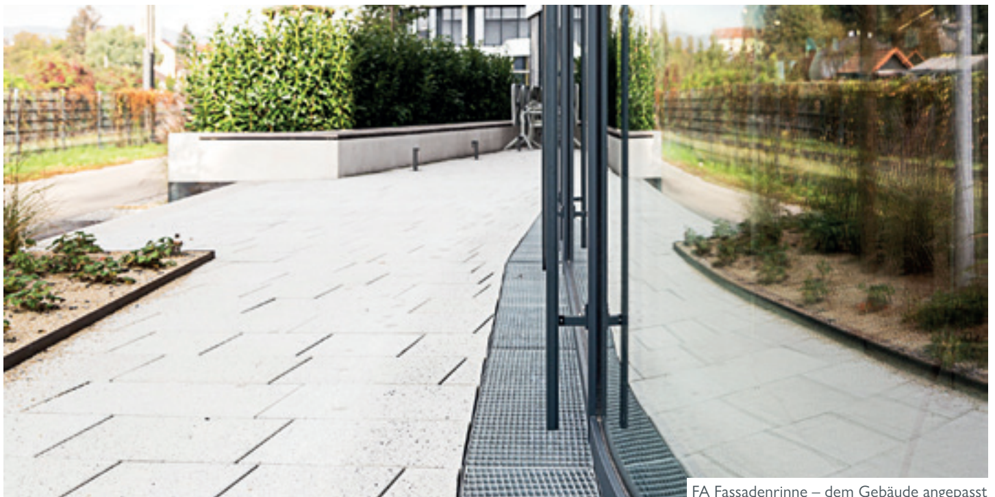
FA Fassadenrinne – dem Gebäude angepasst
